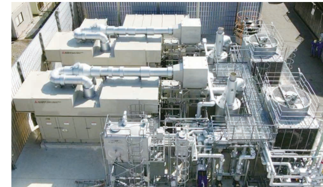
出力合計2,000kWのコージェネレーション設備
