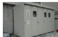
平成28年(2016年) 高効率変圧器導入
